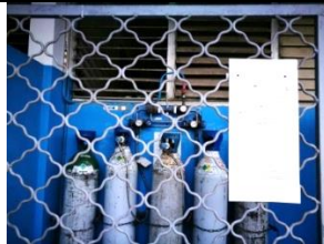
Centrale oxygène (atelier)
